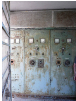
Sala comandi elettrici
